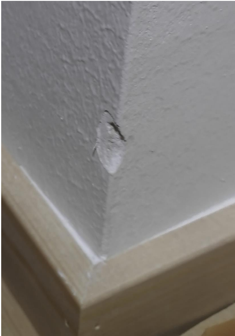
Kuva 19 Seinän ulkonurkka kolhiintunut
