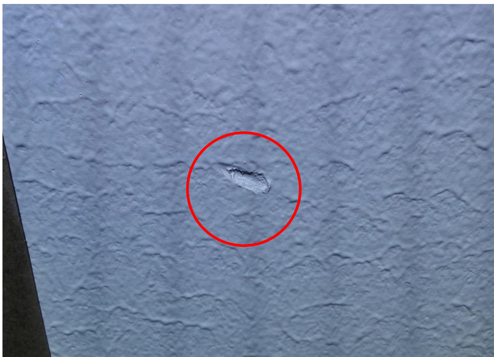
Kuva 14 Valmiiseen seinäpintaan jälkeinpäin syntynyt kolhu
