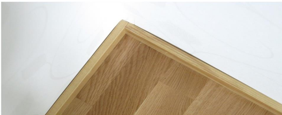
Kuva 11 Esimerkkikuva seinän ja listan välisestä raosta
