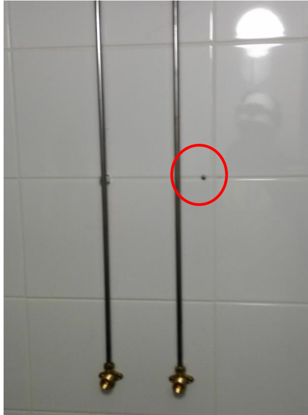
Kuva 17 Vesiputkien kiinnike porattu väärään kohtaan.
